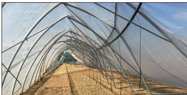
Foto 2: Danni alle strutture a seguito di un Tornado (Brescia, maggio 2019)
