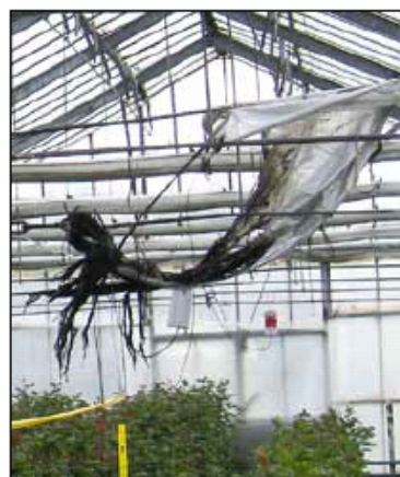
Foto 1: In questo caso il vaporizzatore di zolfo ha causato l'incendio dello schermo isolante. In tali circostanze, in conformità con le Norme assuntive della Gartenbau-Versicherung, si deve utilizzare uno schermo ignifugo, installato a distanza sufficiente.
