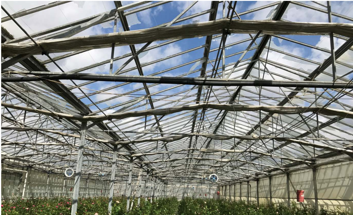
Foto 1: Grandine: Quasi nessuna lastra intatta.
