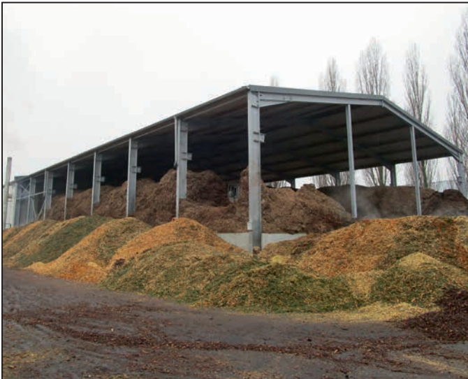
Foto 1: Magazzino per lo stoccaggio del cippato all'aperto sotto una tettoia
