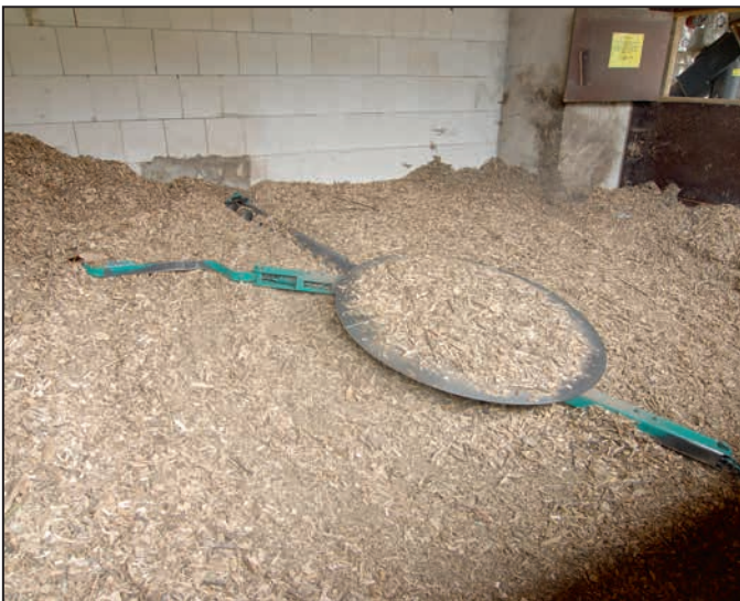
Foto 5: Estrazione con braccio articolato (Foto Azienda döpiK Energietechnik GmbH)
